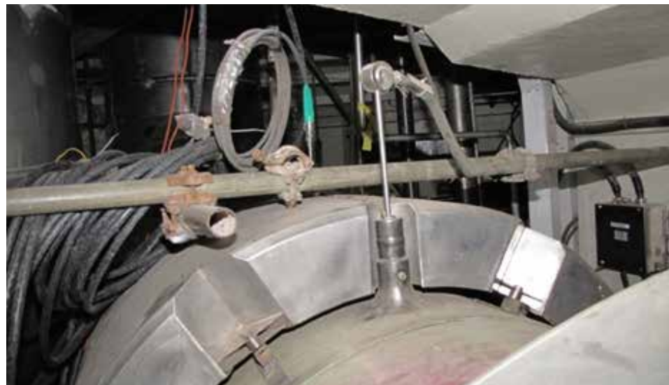
Термоконтроль на главном трубопроводе АЭС
